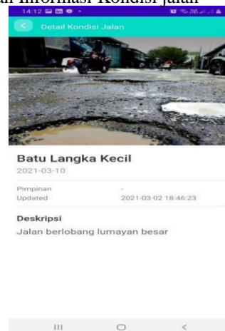
Gambar 24. Tampilan Kondisi Jalan
