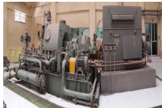
Gambar 1. Generator Sinkron pada WHRPG
